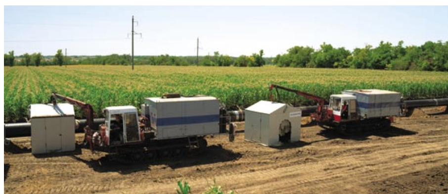
Фото: «Транснефть – ТСД»
