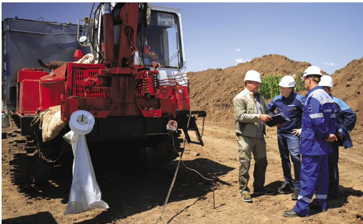
Фото: «Транснефть – ТСД»
